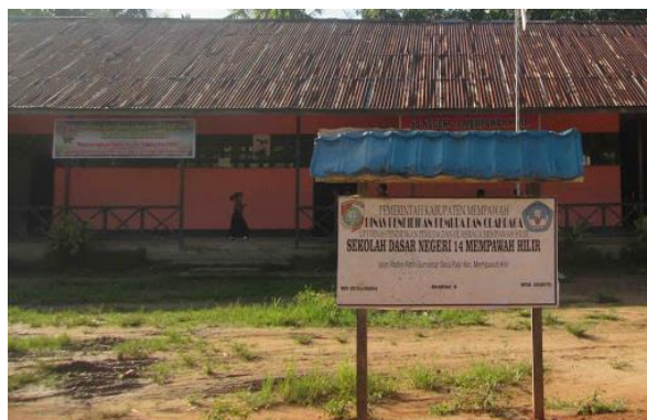
(b) Gedung Sekolah di Kecamatan Mempawah Hilir dengan Pondasi Dasar Tinggi ((Kemendikbud, n.d.)
